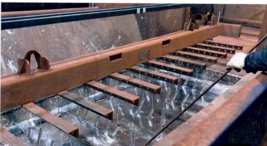
Bauteile werden durch Tauchen in geschmolzenes Zink in den Anlagen bei Pfingsten feuerverzinkt
